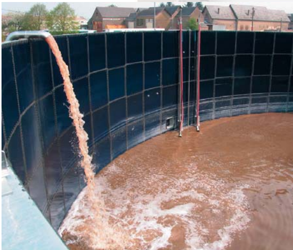
Bomba sumergida AirJet para reducir los olores de los efluentes de un matadero.
