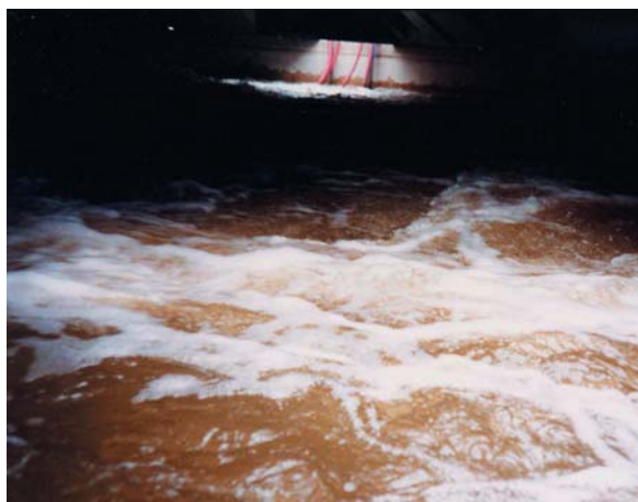
Bomba AirJet sumergida en un depósito de lixiviados.
