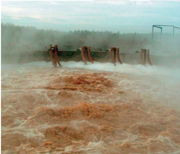
Las bombas sumergidas AirJet en un depósito de aireación de una papelera.
