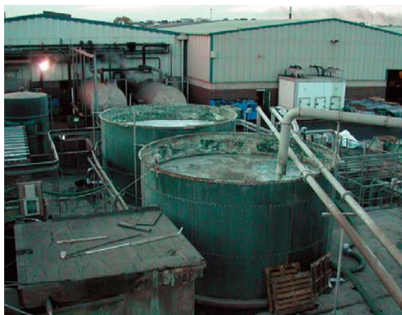
Bomba AirJet instalación en seco para un depósito de aireación de una fábrica de curtidos.
